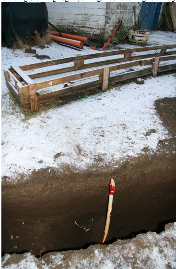
Mynd 1. Norðausturendi skurðarins. Skóflan sýnir hvar vatnsleiðslan, sem tengja þarf inn á, liggur í átt að vélaverkstæðinu á Keldum, sem sést í baksýn (GÓL-2007-25-14).
